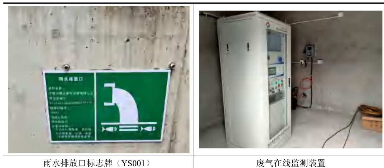
图 4.2-2 废气在线监测装置
